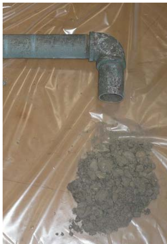
写真 2.3.1-3 配管から取り除いたグラスウール
