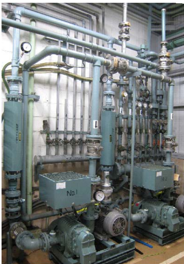
写真 2.3.1-1 停止したブロワの外観
